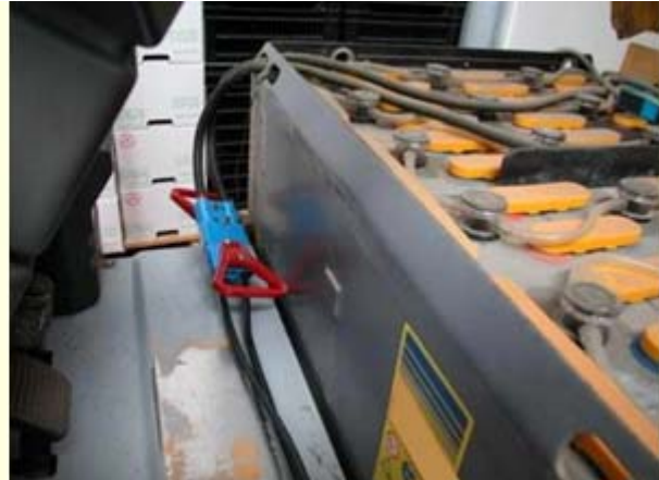
collegamento con il carica batterie
