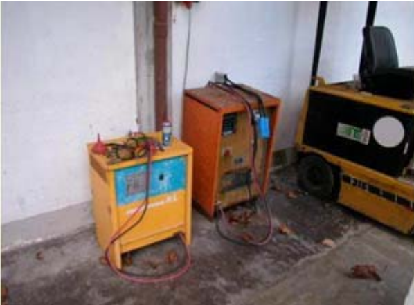
carica batterie all'aperto all'esterno
