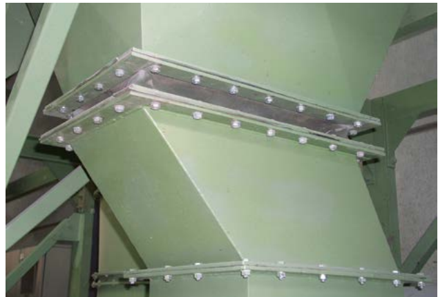
69 Elemento di compensazione in plastica posizionato nella condotta di scarico dell'aria di un impianto di processo.
