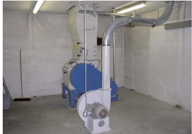
77 Trituratore di materie plastiche in un locale separato.
