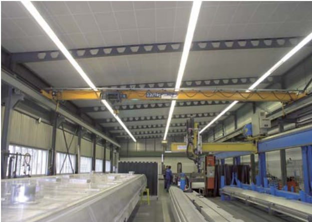
80 Soffitto fonoassorbente in un locale dove si effettua la saldatura di alluminio.
